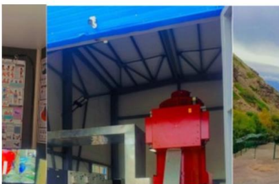
Гидроэлектростанция в Алматинской области, Райымбекский район, на реке Орта Какпак, вблизи поселка Какпак
